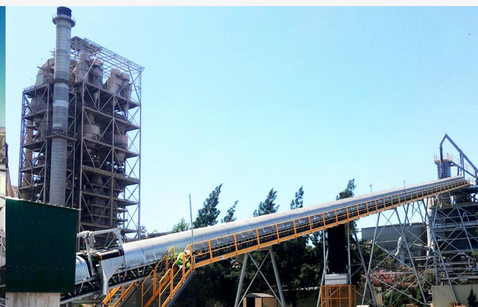
Instalación para uso de biomasa, en Sevilla, España
