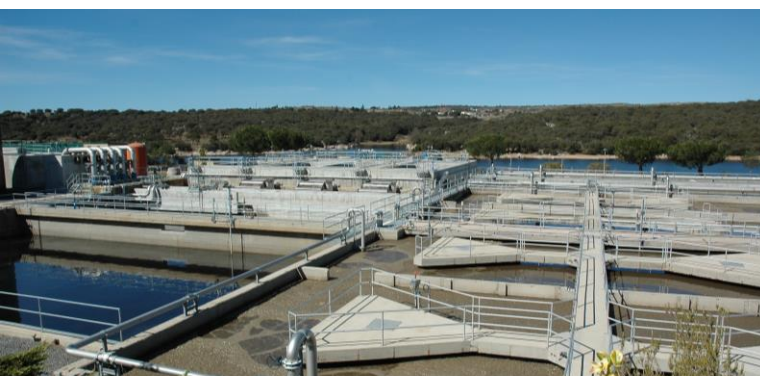
Estación depuradora de aguas residuales en Ávila, España
