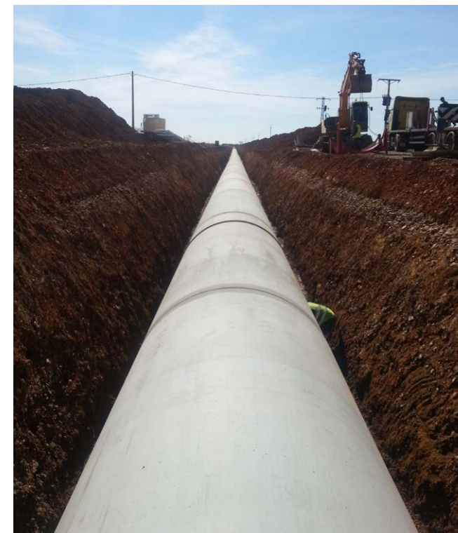
Tuberías para conducciones hidráulicas.
