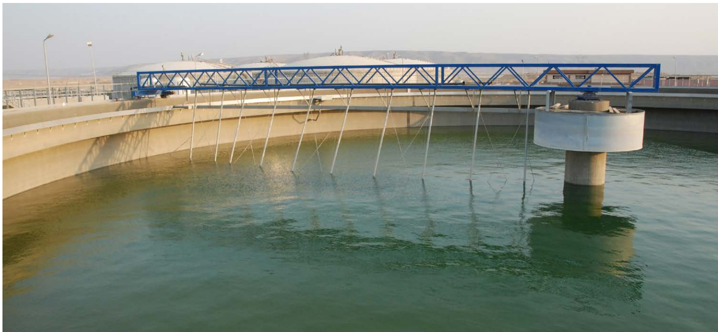
Depuradora New Cairo (Egipto).
