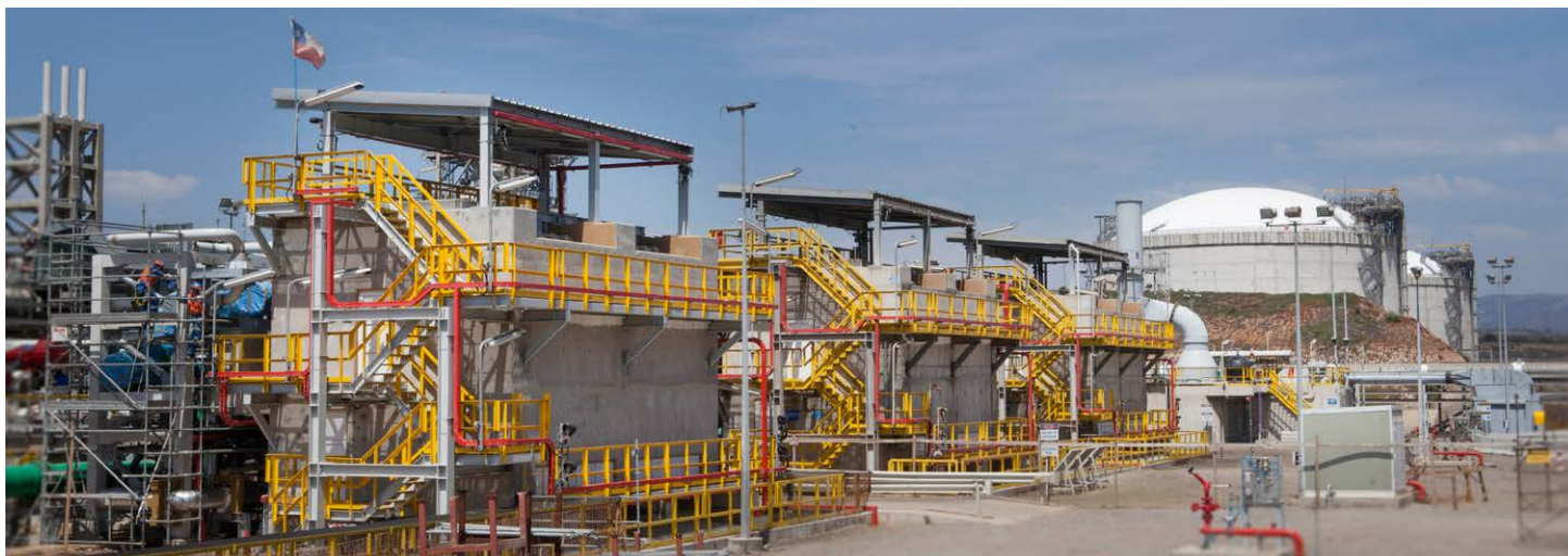
Planta de regasificación de GNL. Quintero (Chile).
