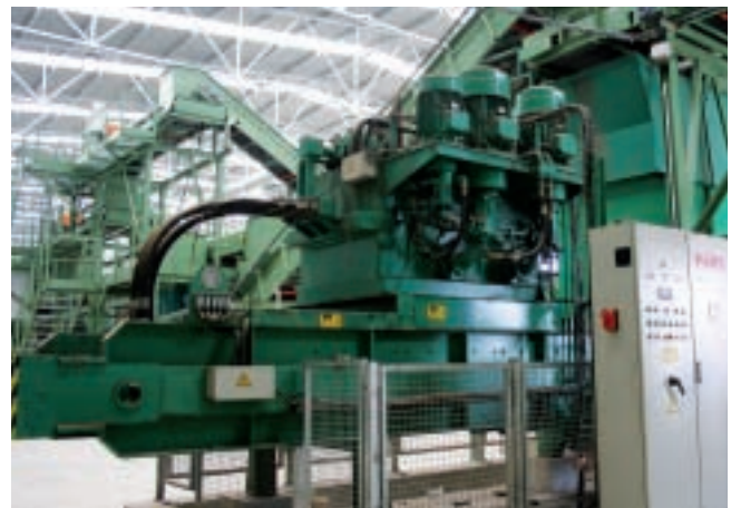
Planta de tratamiento de residuos sólidos urbanos. Tudela. Navarra
