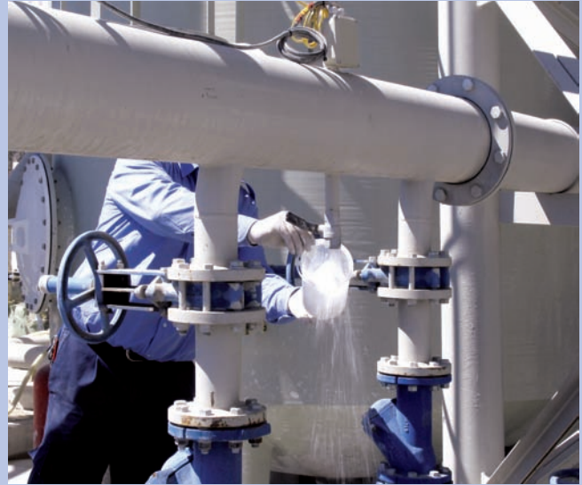
Estación depuradora de aguas residuales. Consentino. Almería
