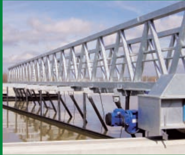
Depuradora de aguas residuales. Salamanca
